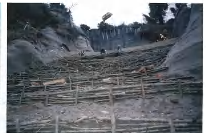
Right: Bioengineering./ À droite : Un ouvrage de bio-ingénierie de taille.
