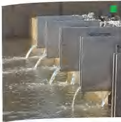
Scuppers in the south pond flowing with rainwater after a downpour/L'écoulement des eaux pluviales depuis les dalots jusqu'à l'étang sud après une averse
